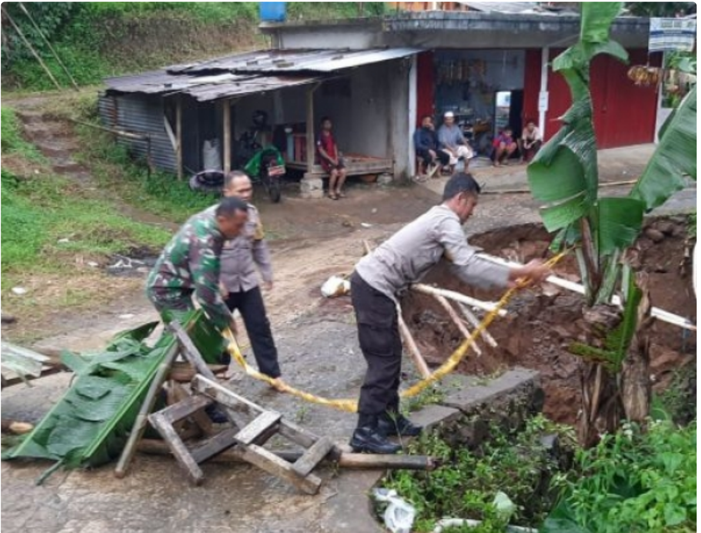
Polisi Pasang Garis Polisi di Jalan Desa Yang longsor Cegah Kecelakaan
